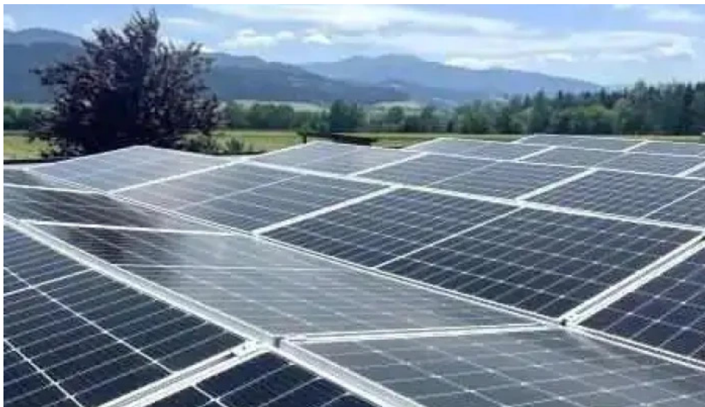
Lr photovoltaik gmbh kobenz
