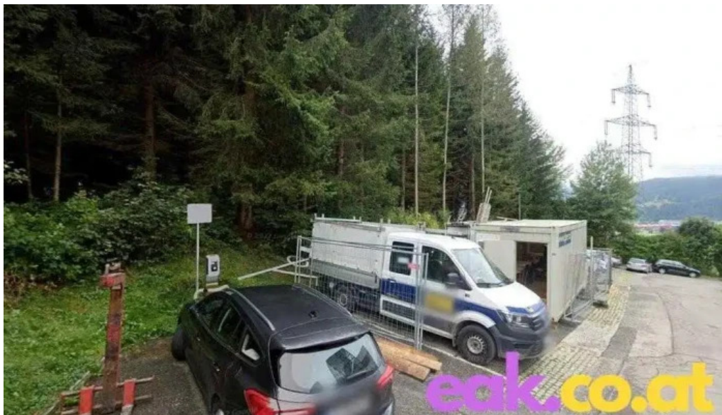
Energie steiermark charging station st barbara im murztal
